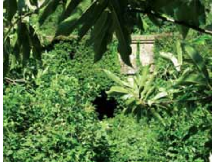
Il Ponte di Durazzano quasi completamente coperto dalla vegetazione.
